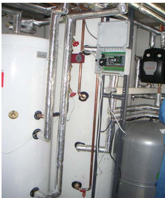
Pufferschichtspeicher und Brauchwasserboiler
