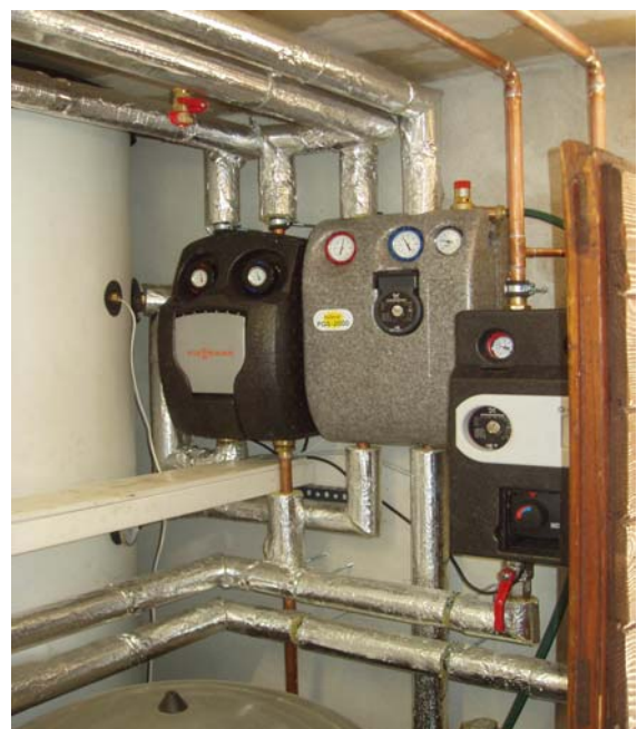
Verteilerpumpe und Kupferrohrleitungen
