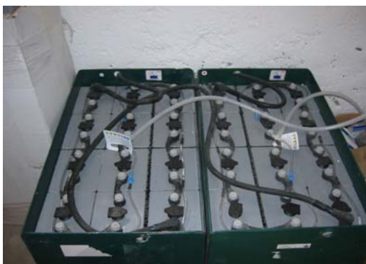
Batteriespeicher 48V/920 Ah
