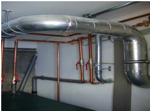
Tankraumbeheizung mit BHKW Abwärme
